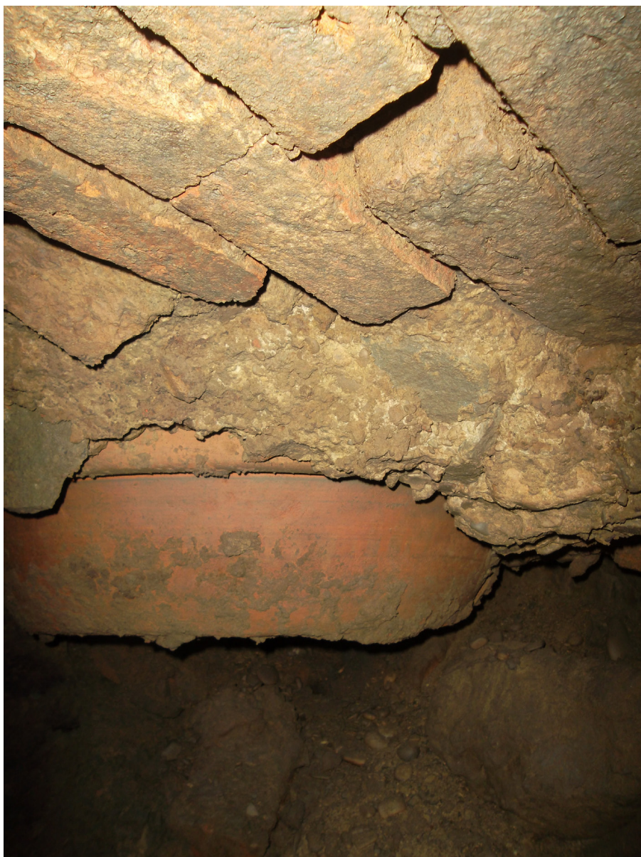
Figura 97: Il fondo del grande orcio in terracotta nel vano INT 7, sospeso sopra ad una camera inferiore voltata a mattoni
