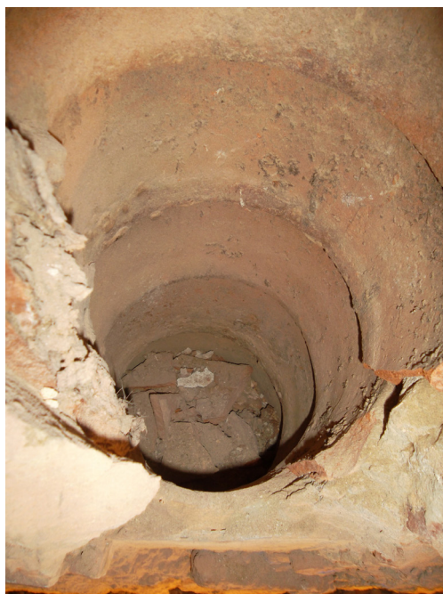
Figura 99: L'interno nel vano INT 7 di una delle tubazioni di scarico dei liquami dal gabinetto di servizio creato nel 1748 (corrispondente al vano PT 5 soprastante il vano INT 7), tubazione diretta all'orcio della Figura 96
