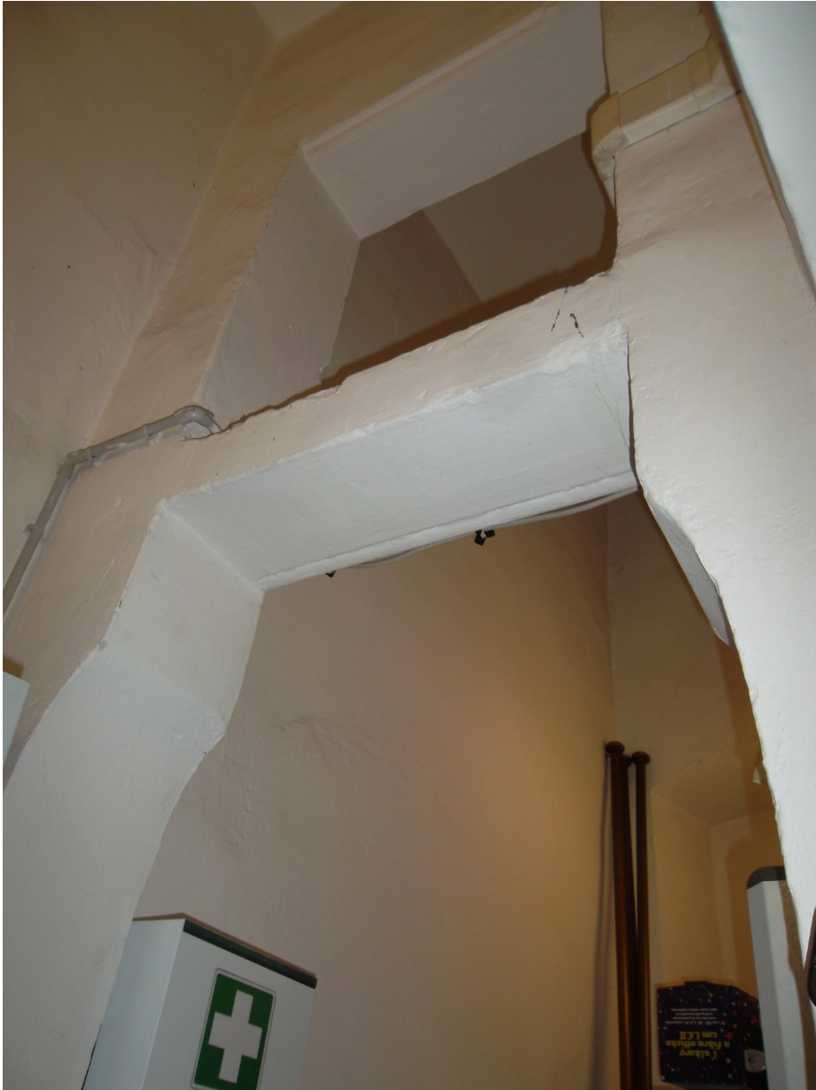
Figura 85: Portalino ad arco ad ogiva nel ripostiglio dietro la portineria attuale, sopra INT 7
